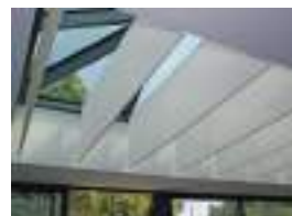
Plafond et baffles - Restaurant (FR)
